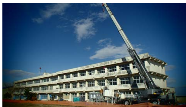
図4 東北地方に緊急設置されたマイクロ波方式アスベスト無害化処理。この試験では、処理施設として津波により無人となった校舎を利用している。
